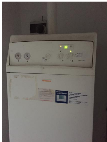
Figura 4.12 – Particolare del generatore di calore a basamento
