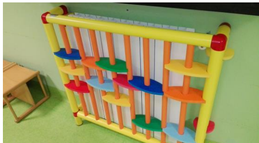
Figura 4.9 – Particolare – radiatore in ghisa – scuola elementare
